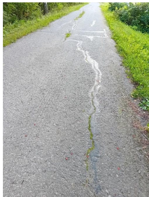
Kuvassa 4 näkyy tiessä oleva railo.
